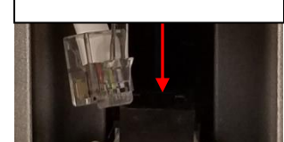
Cable de la Celda de Carga No Conectado
